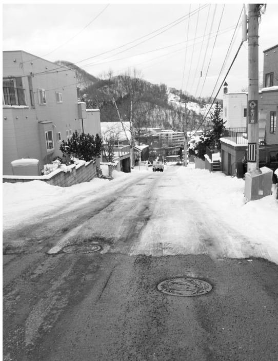
現場の様子。凍りやすく、自動車のスリップが起こりやすい。[坂の上側(写真手前)]はロードヒーティングが設置されているが、溶けた水が坂の途中でこぼれて凍って危険。側溝を設置できないか』との要望が寄せられた。
